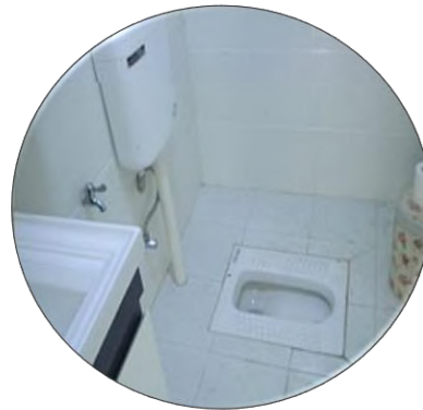
Cistern flush toilet
